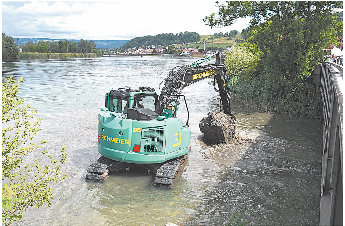
Eine neue Kaltwasserzone für die Fische: Dort, wo die Surb in die Aare mündet, wurde das Bachbett am Dienstag bis auf eine Tiefe von knapp zwei Metern und auf einer Länge von 20 Metern (in Blickrichtung) ausgebaggert.
