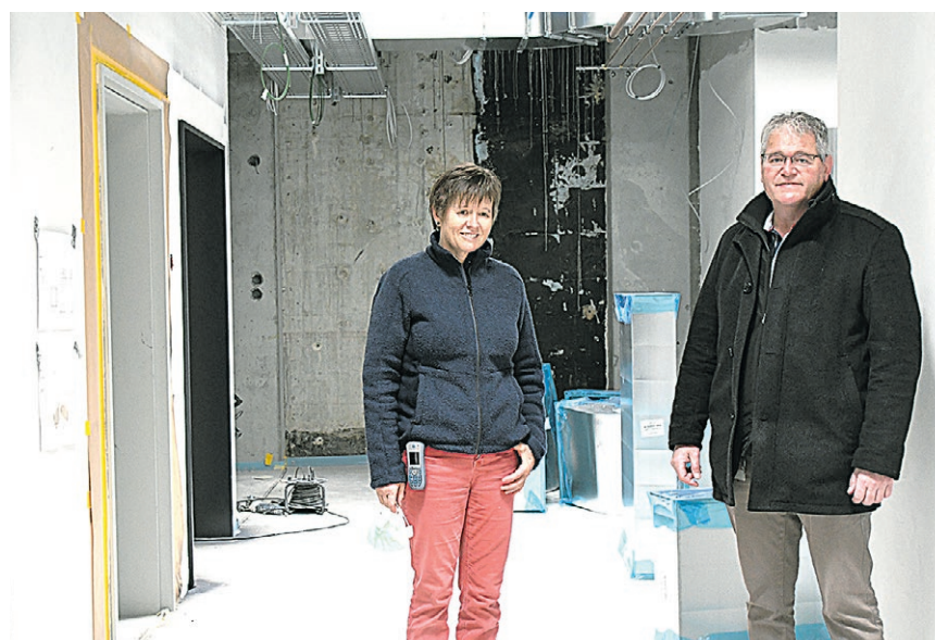
Ursula Keller, Leiterin Pflegedienst, und René Huber, Spitaldirektor, auf der Baustelle des neuen Spitalanbaus: Hier entsteht bis im Sommer das neue Institut für Radiologie.
