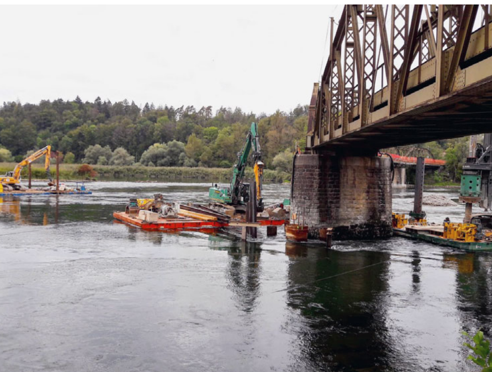
Verstärkt werden die Brückenpfeiler, um künftig besser gegen Hochwasser geschützt zu sein.
